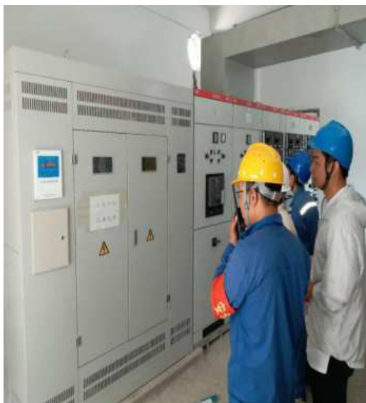
湿式电除尘配电室
