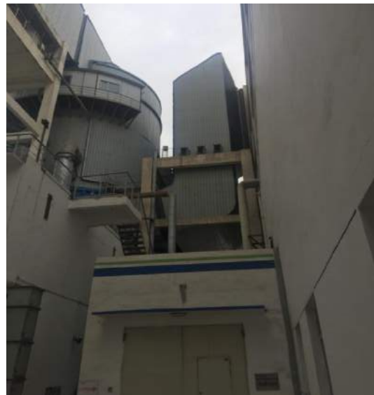
余热换热器与脱硫系统接口烟道(外侧视角)
