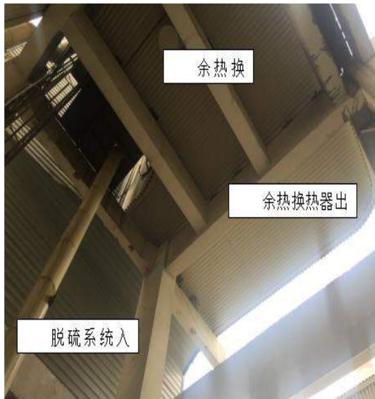
余热换热器与脱硫系统接口烟道(内侧视角)
