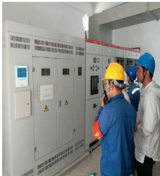
湿式电除尘配电室
