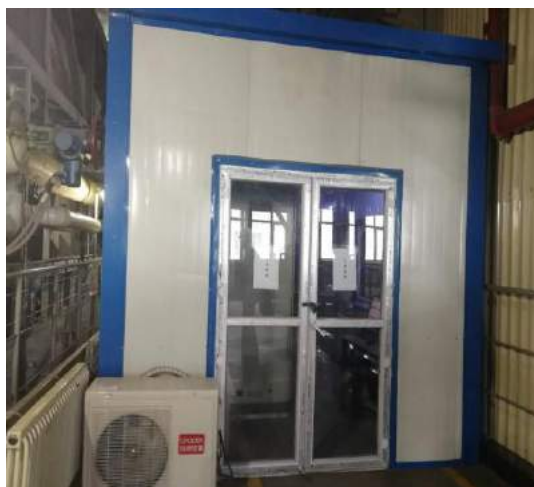
脱硝在线监测站房
